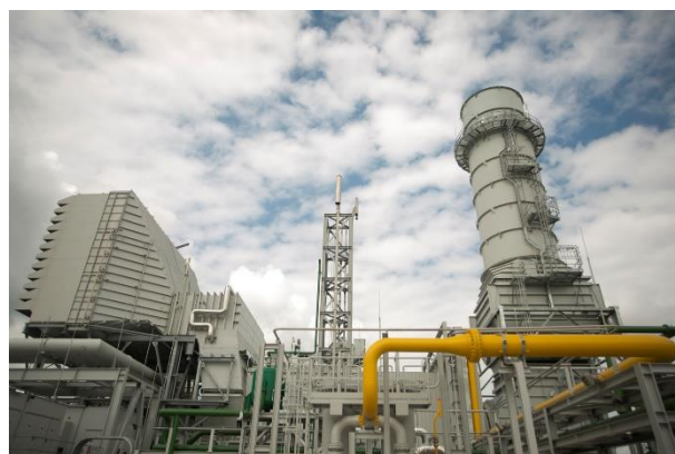
Central Térmica El Bracho
